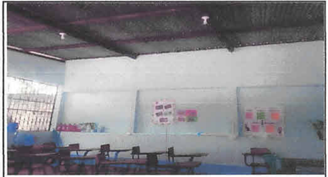
Foto 8: Repello y alizado dentro y fuera del salón I, de igual manera se estará instalando el sistema eléctrico colocando plafoneras y tomacorrientes y se estará pintando dentro y fuera del salón I.
